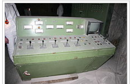
Steuerpult der Krananlage für das Ablassen der Fässer mit mittelaktivem Abfall. Der Bildschirm rechts bot einen Blick in die Kammer 8a
